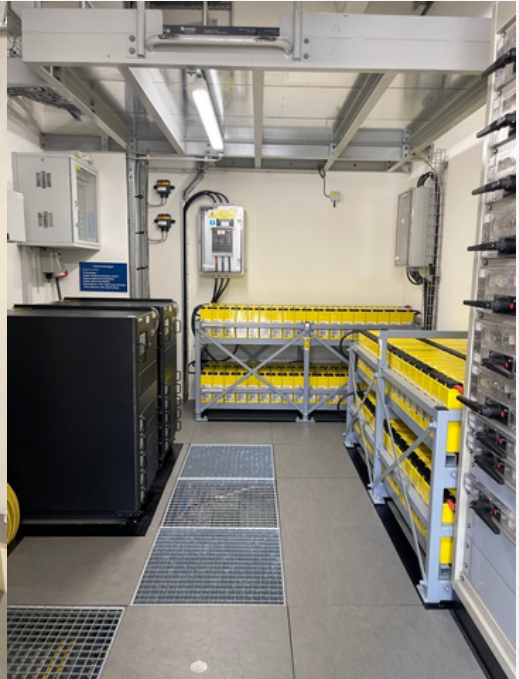
Redundantes Batterie System
