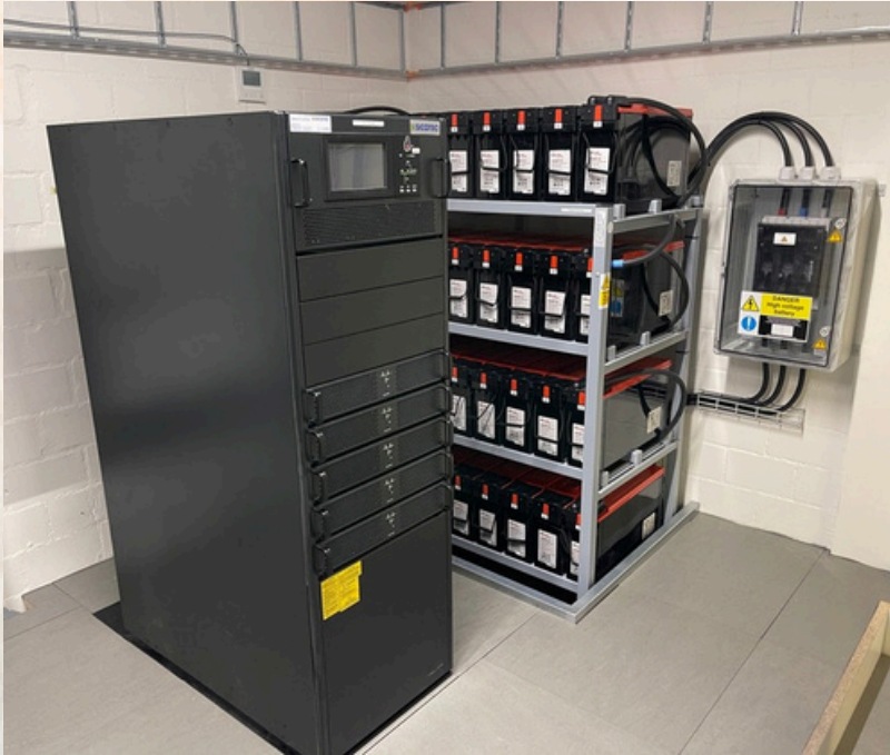
Modulare USV mit Batterien auf Gestell
